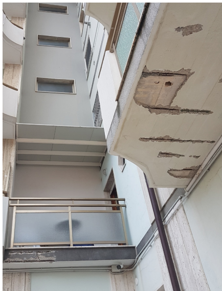
Stato di degrado dei balconi esistenti.
