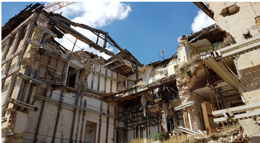
Aggregato Pretatti-Loddi, vista del fabbricato con i crolli su via Pretatti a seguito degli eventi sismici del 2009.
