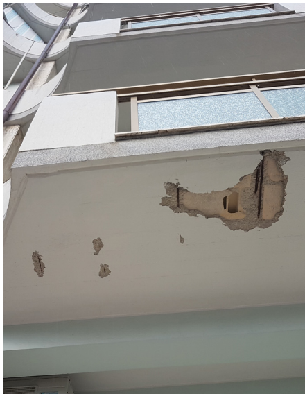
Un dettaglio del degrado dei balconi esistenti.
