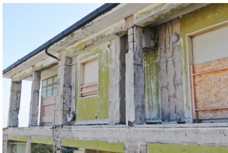
Alcune strutture in c.a. deteriorate nel fabbricato esistente, durante i lavori.
