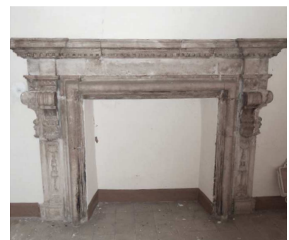
Il camino prima del restauro.
