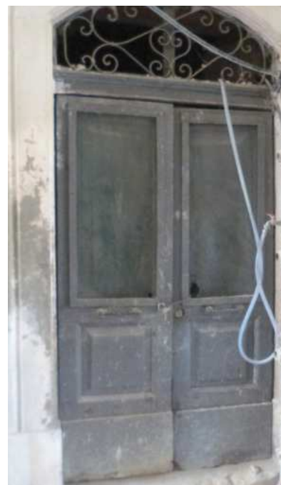
Infisso storico prima del restauro.
