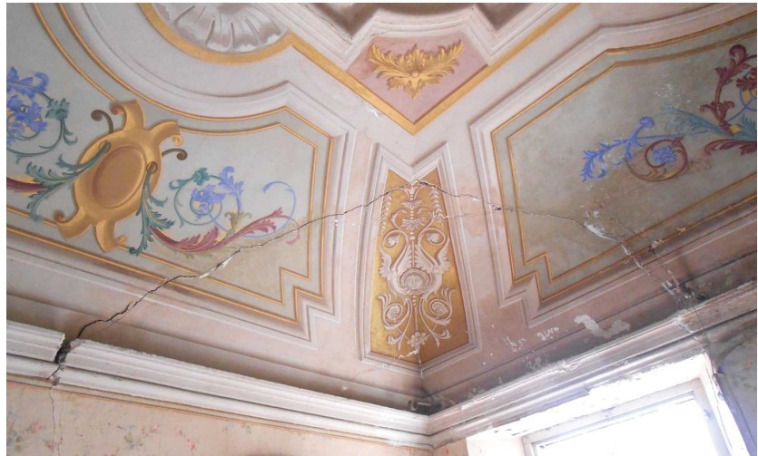
Fessurazioni e fenomeni di abrasione prima dei lavori di consolidamento.
