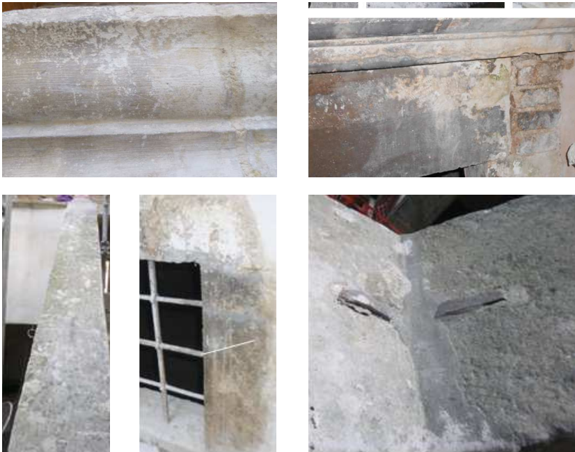
Disgregazioni, esfoliazioni e fenomeni di scagliatura.
