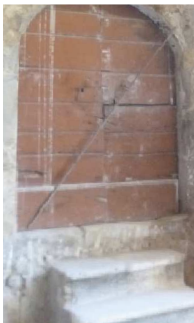
Infisso storico prima del restauro.
