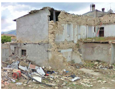
Parte del fabbricato dopo il sisma.
