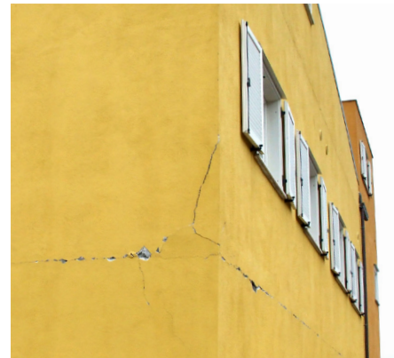
Lesioni create dall'evento sismico.
