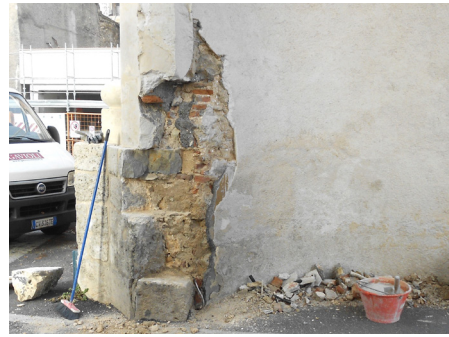
Particolare degli elementi lapidei danneggiati.
