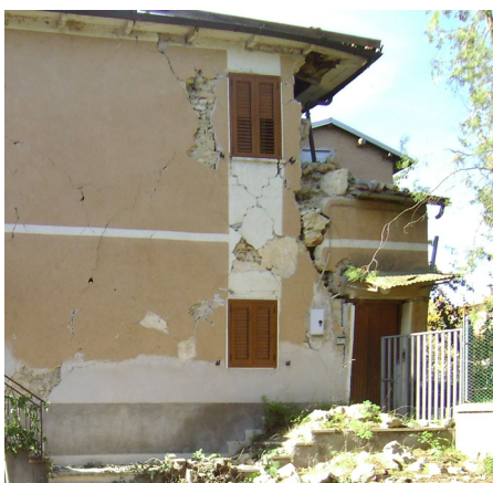
I danni provocati dal sisma del 2009.
