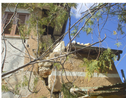
Particolare di una lesione causata dal sisma.
