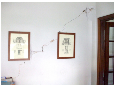
Lesioni dovute al terremoto.
