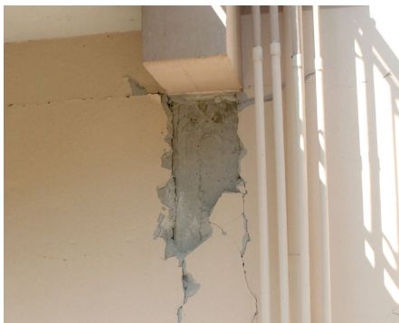
Lesioni dovute al terremoto.
