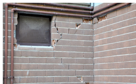
Lesioni alla cortina dovute al sisma.
