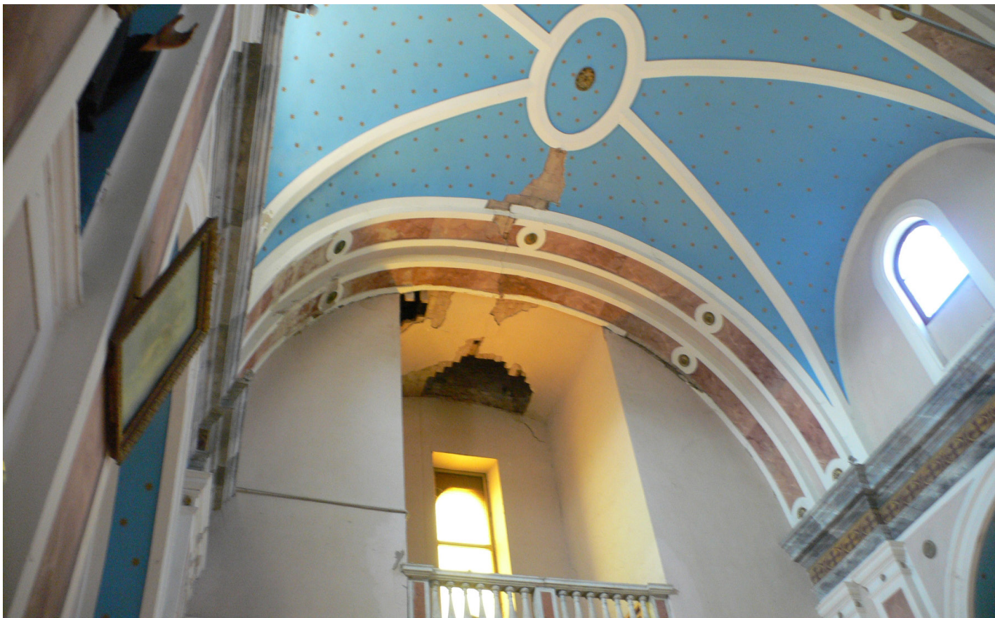
La volta con crolli parziali e lesioni interne subite a seguito del sisma.
