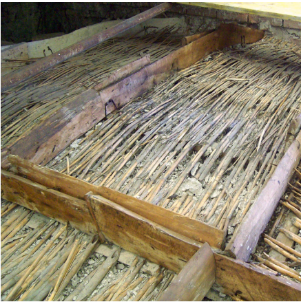
Estradosso della volta prima del consolidamento.
