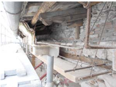
Il cornicione crollato a seguito del sisma.
