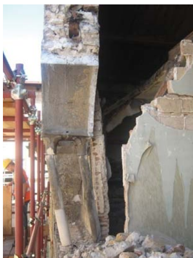
Parte crollata sovrastante il loggiato su Via Casella.
