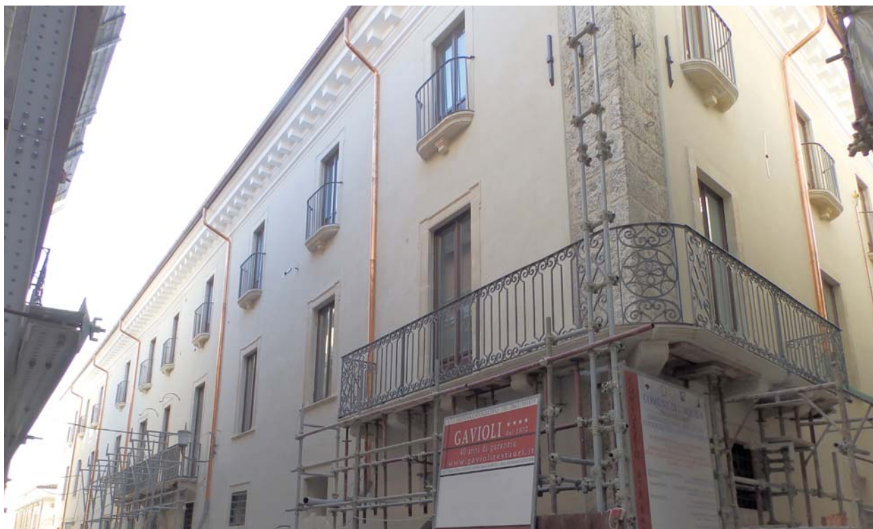
Prospetto posto fra Via Cimino e Via S. Giusta durante le fasi di ultimazione dei lavori.
