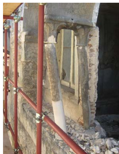
Colonnine in pietra della trifora danneggiate dal sisma.
