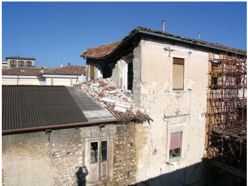
Porzione sommitale dell'aggregato danneggiata a seguito del sisma.
