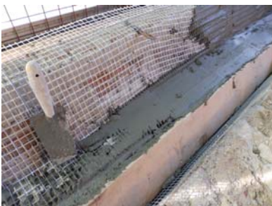
Consolidamento dei cornicioni tramite applicazione di composito con fibra sulla parte estradosale.
