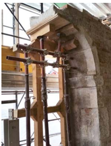
Parte crollata del loggiato su Via Casella.
