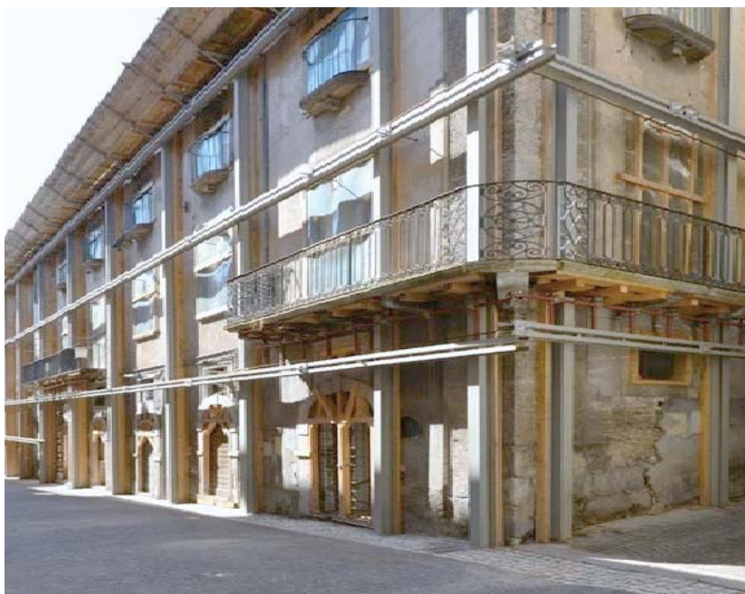
Prospetto posto fra Via Cimino e Via S. Giusta, pre-intervento di consolidamento-restauro.
