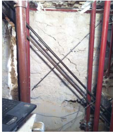
Configurazione fessurata del pannello al termine della prova di compressione diagonale.
